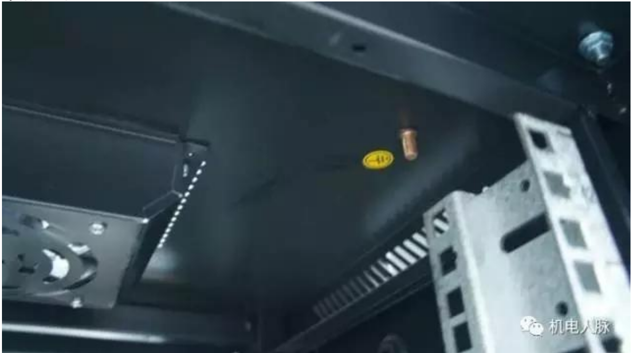
图6.2.10设备金属外壳未接地
