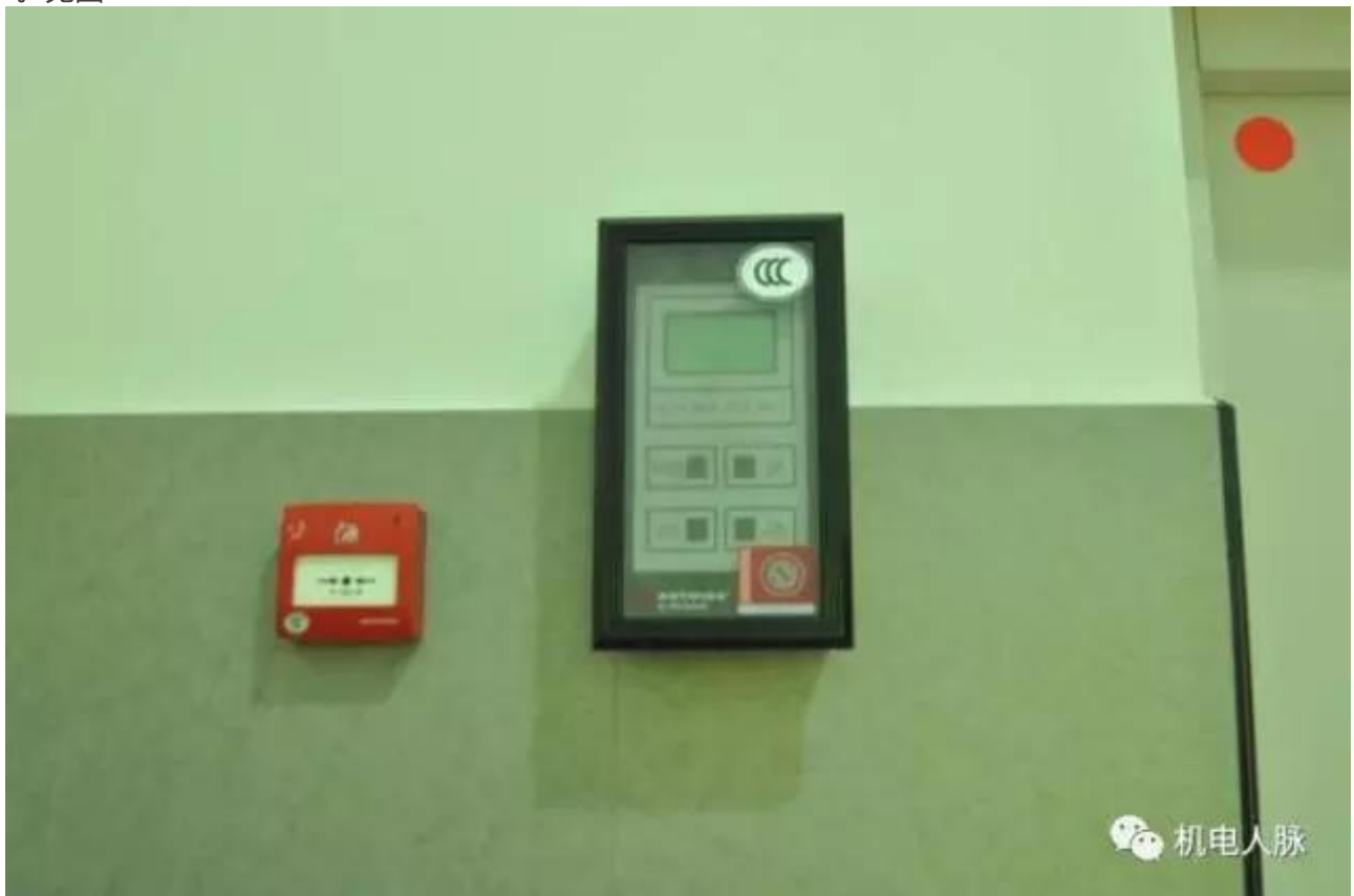
图6.2.5-1区域显示器安装
